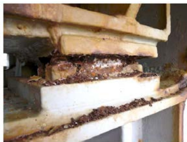
Abb. 2.6 Gerbergelenk bei FÜ 2 (fest) Korrosionsschäden 2010
