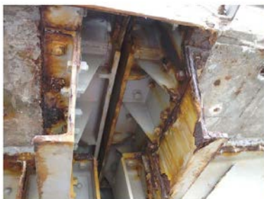
Abb. 2.5 Randbereich bei FÜ 2 (Einfachprofil), OWS Korrosionsschäden 2010
