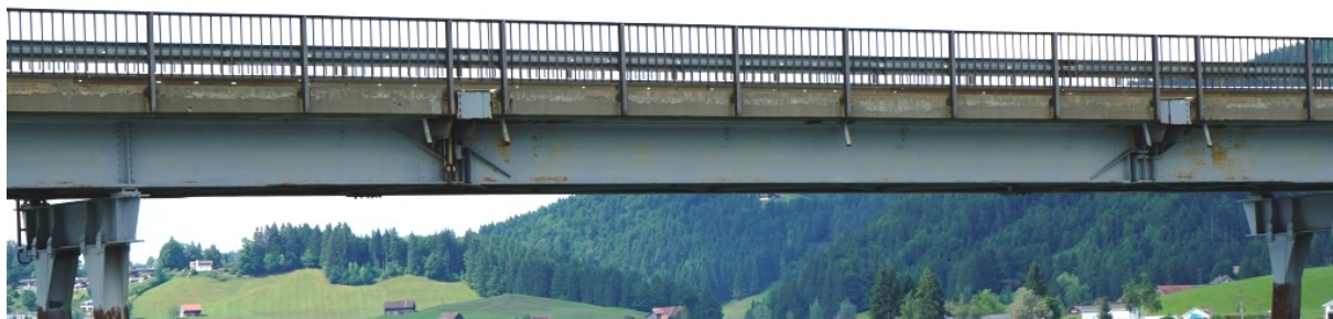
Bild 7. Korrosion der Stahlbauteile der Gerbergelenke bei den Fahrbahnübergängen. Oben links und Mitte: Aufnahmen von 2010 (aus [19]); Oben rechts und unten: guter Zustand von Gerbergelenken im Juni 2017 20 .
