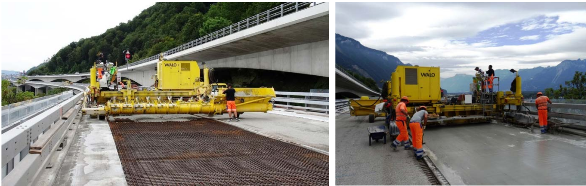
Bild 12. Einbau von Frisch-UHF mit einem Fertiger auf dem Chillon-Viadukt bei Montreux (Fotos: August 2014).
